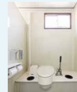
[室内/ポンプ式簡易水洗]
