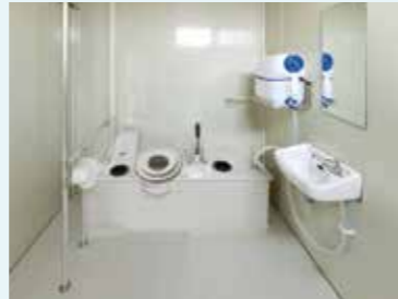
[室内/ポンプ式簡易水洗]
