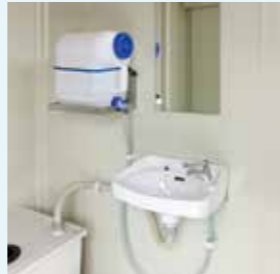
[手洗器/ポンプ式簡易水洗]
