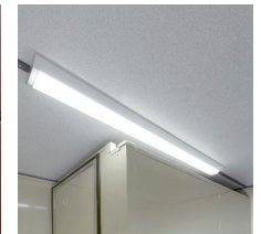
⑤ 照明設備
